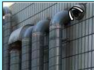
排気ダクト周り
