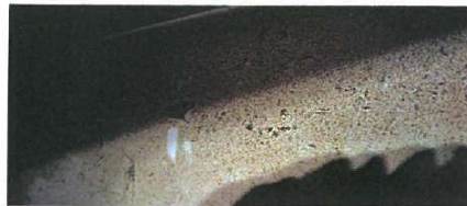
レンジ横の壁面。食用油の飛び散りがある。市販の油污れ用洗剤で落としきれず。
